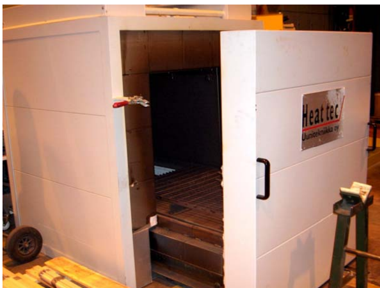
Kuva 12: Heat Tec Uunitekniikka Oy kiertoilmauni, Konecranes Service Oy.
