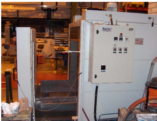
Kuva 10: Heat tec Uuniteknikka Oy:n valmistama vaunu-uuni, Konecranes Service Oy.
