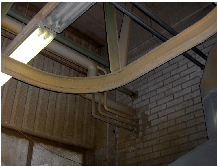
Kuva 16: Nostimen radan korkeutta rajoittavat happi- ja nestekaasuputket.
