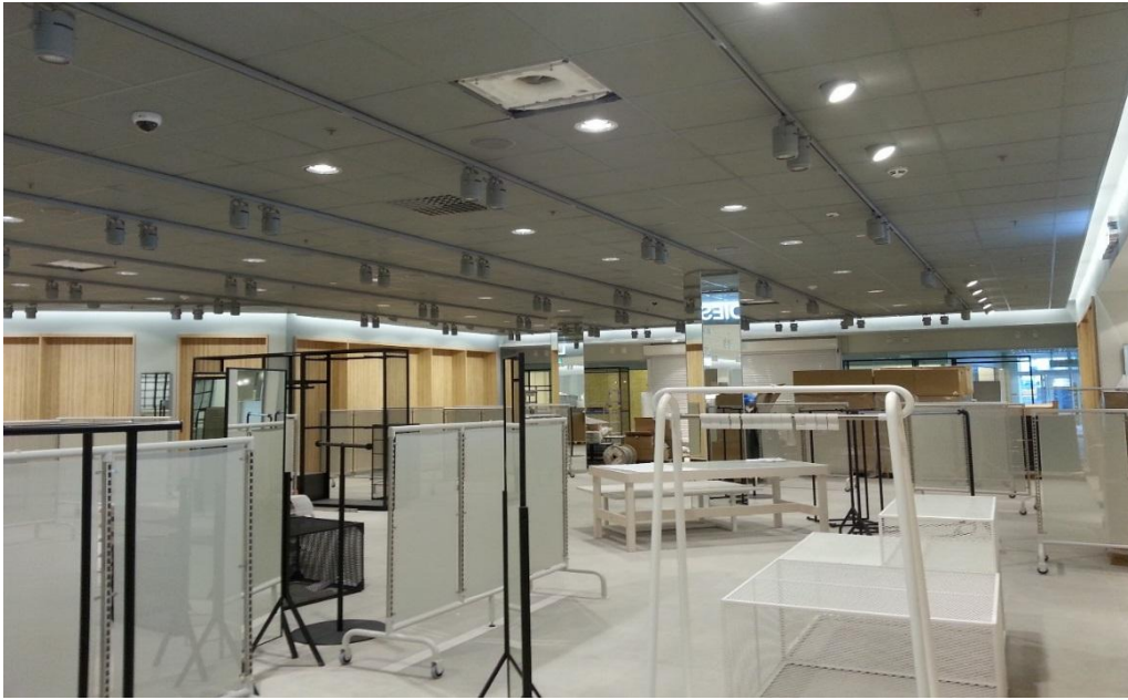
KUVA 12. Alakatto sisälsi runsaasti valaisimia ja muuta tekniikkaa
