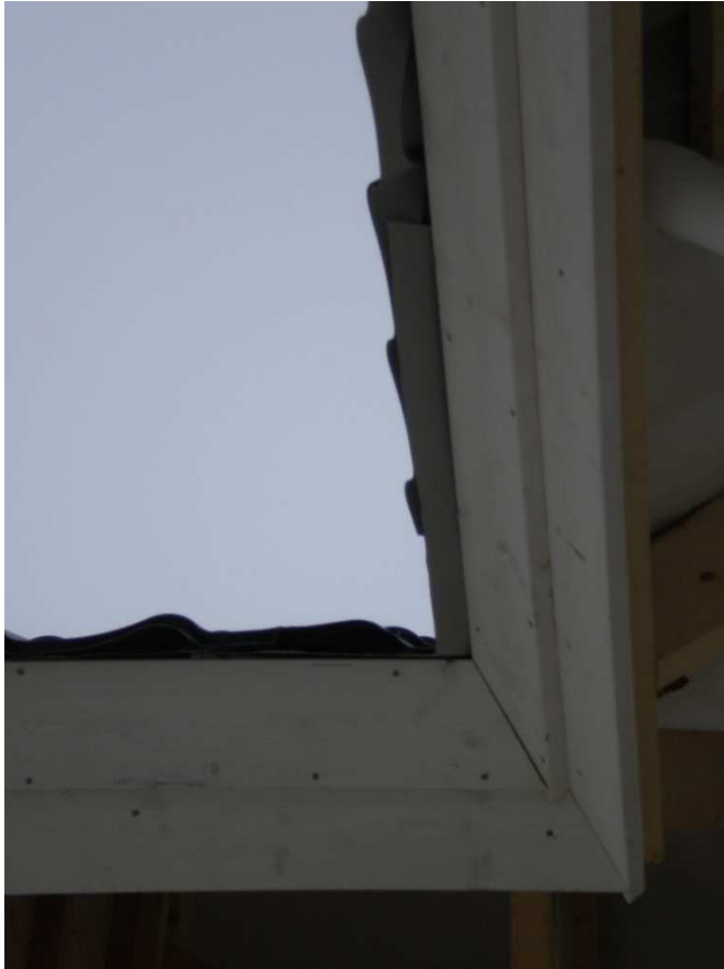
Kuva 46 Jiirinpohjapellin ylitys räystäällä (Hintikka 2013-11-06)
